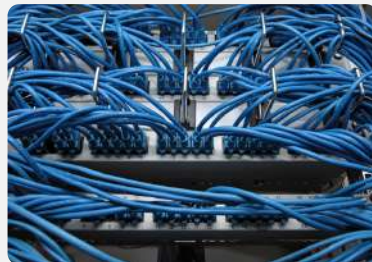
CABLAGGIO DI EDIFICI
